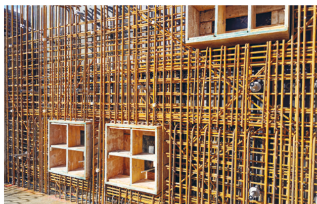
Im August 2019 wurde mit dem Aushub für die dritte Biologiestrasse und für die Elimination der Mikroverunreinigungen begonnen.
