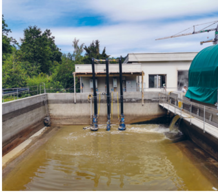
Während der Sanierung und Erneuerung des Rechengebäudes wurde der gesamte Abwasseranfall über das Dach geführt.
