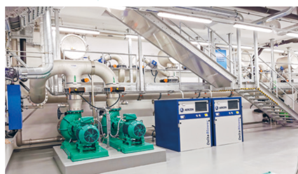
Hinter den Betonmauern befinden sich die vier Sandfilterzellen, davor ist die Ausrüstung der Sandfiltration zu sehen. Rundum ein gelungenes Bauwerk.
