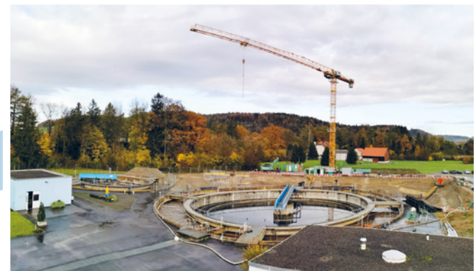
Im August 2019 wurde mit dem Aushub für die dritte Biologiestrasse und für die Elimination der Mikroverunreinigungen begonnen.
